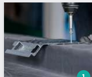
1 Plaats de SnelKlik klangen om de 60 cm op de dakrand en bij elke verbinding tussen twee deklijsten.
